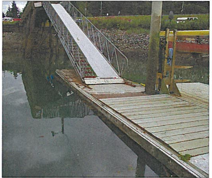
AURORA 056.jpg LOW FREEBOARD AT "N" GANGWAY
