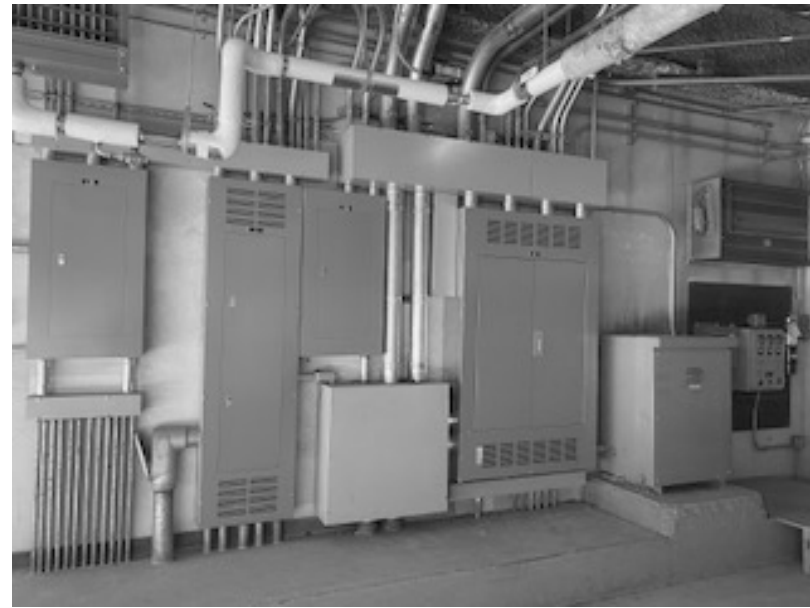
2 Photo_PANELBOARDS ED101 SCALE: NO SCALE
